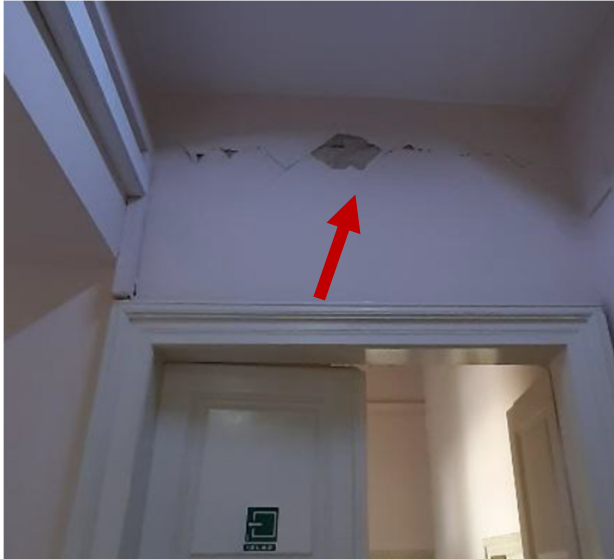
Fotografija 35 Pukotine na nadvoju iznad vrata drugog kata
