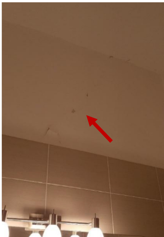
Fotografija 19 Pukotine na nosivom zidu prvog kata
