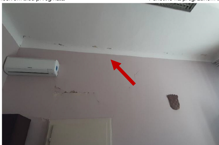
Fotografija 21 Pukotine na pregradnom zidu prvog kata
