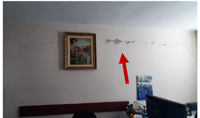
Fotografija 36 Pukotine i odlamanje žbuke na pregradnom zidu potkrovlja
