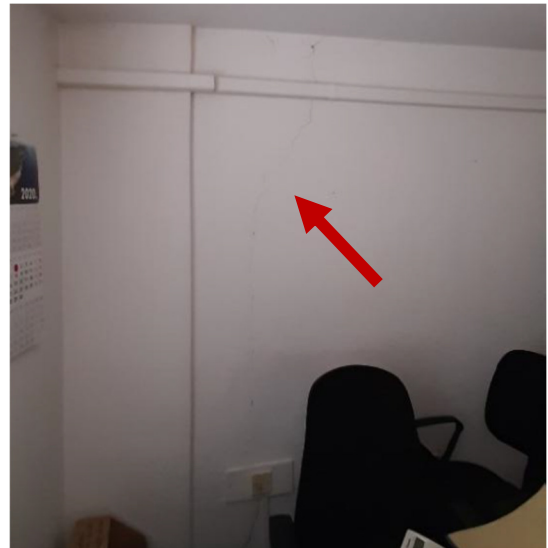
Fotografija 38 Pukotine na zabatnom zidu potkrovlja
